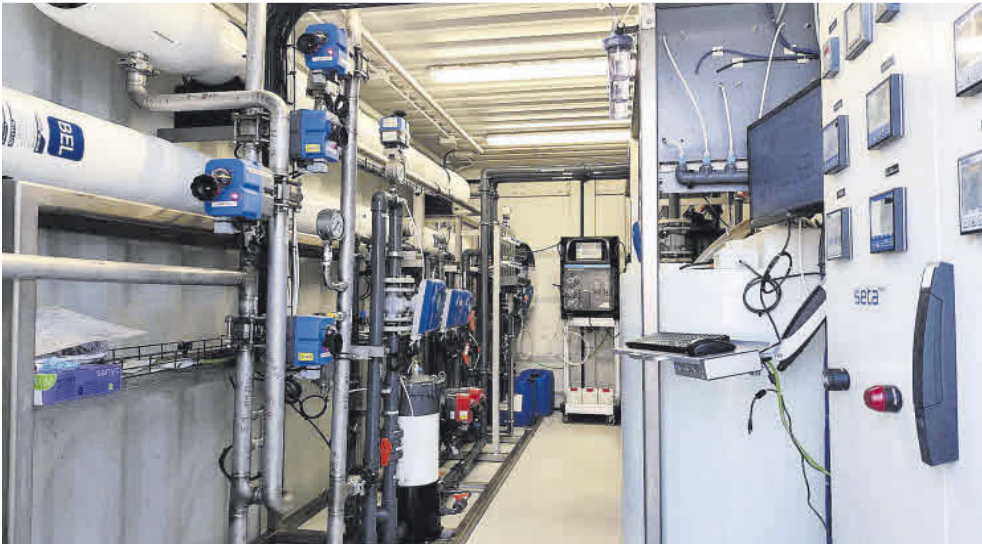
Interior de una de las plantas de ensayo en Pozo Izquierdo, Gran Canaria, donde se lleva a cabo parte de la investigación.
